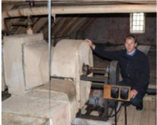
Kurt Kristensen ved det gamle varmeanlæg på kirkeloftet i Løvel.
